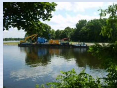
Zyklonanlage zur Schlamm-entwässerung
