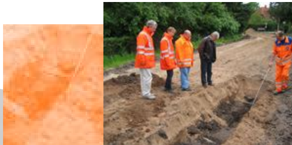
Ortsbesichtigung nach dem Aufbruch der alten Fahrbahn (v.links H. Isensee, Fr. Schütt, H. Gütz, H. Sauerteig, H. Auswald)
